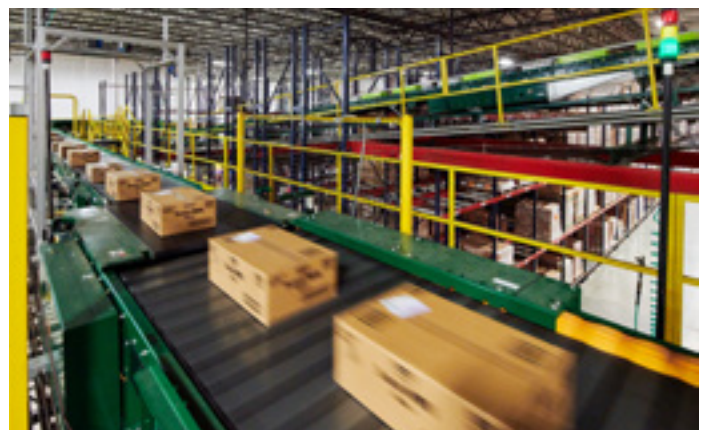
Automatización Fija Parcial: cintas transportadoras, paletizadores, lanzaderas de pallet, elevadores verticales
